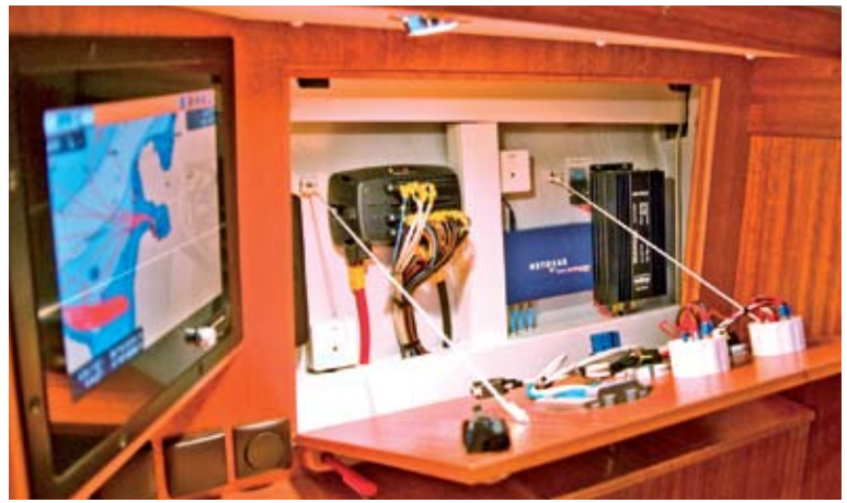
Hochmoderne Bordelektronik mit BUS-System und Navigations-Netzwerk.
